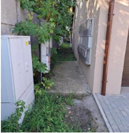
13. kép: A terület bejárata melletti villamosenergia lecsatlakozás.
