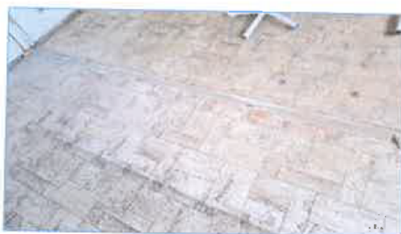
PVC padlóburkolat állapota
