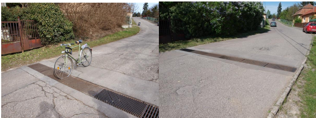
40. ábra: Jó példa a Sánca utcából - 2015-ben a hosszirányú rácsozást harántirányúra cserélték, így megszűnt a balesetveszély
